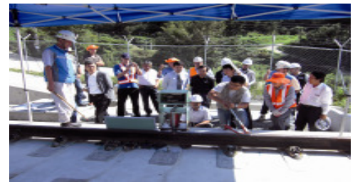
Mitarbeiter des Gleisbaus in Südkorea mit den deutschen Unterstüzern (Bild: Hydro Tech GmbH).
